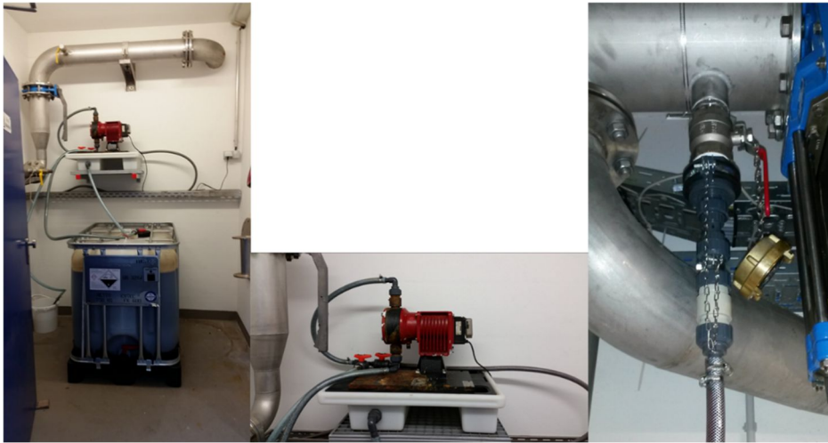
Abb. 8: Aufbau einer Dosierstelle für Entec® FK600: Links - Ansicht der kompletten Dosieranlage mit IBC; Mitte – Dosierpumpe mit Auffangwanne; Rechts – Impfstelle mit Dosierlanze in Schlammleitung
